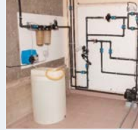
Instalaciones de Agua de bebida
